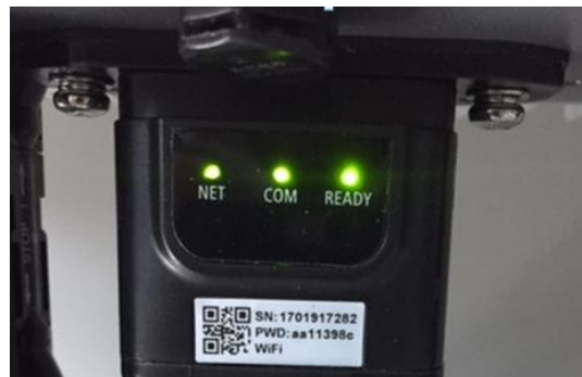
Figure 125 - État final des led
