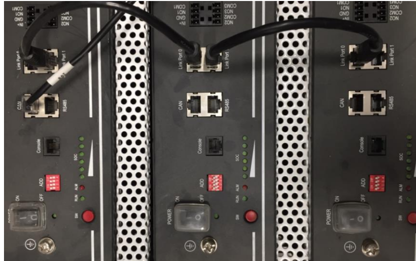
Figure 14 – Connexion de communication entre trois batteries Pylontech
