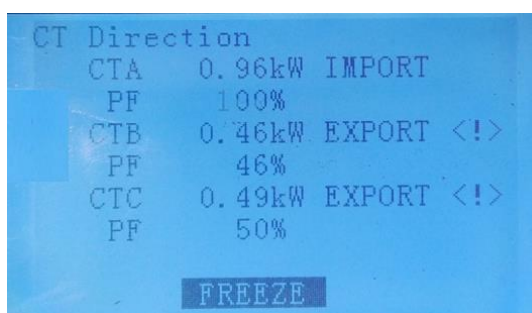
Figure 87 – Cas des sondes CTb et CTC installées sur des phases incorrectes
