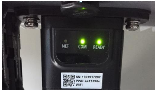
Figure 124 - État initial des led
