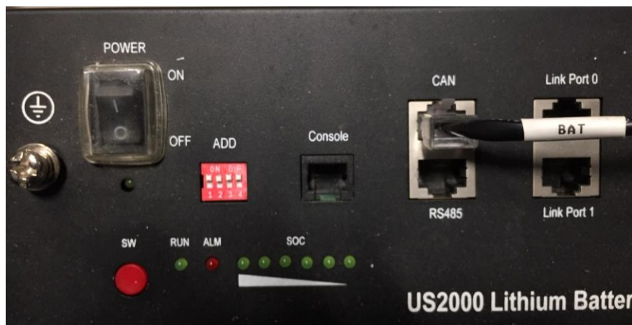
Figure 12 – Connexion du câble de communication sur la batterie Pylontech
